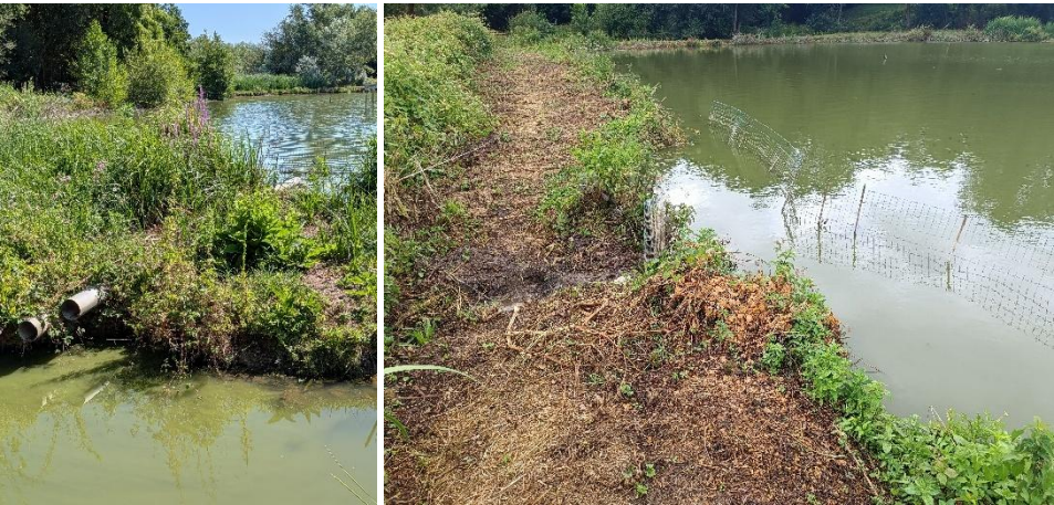
Figure 28 : Dysfonctionnements : Déchaussement des ouvrages de vidange du plan d'eau et de la digue / ragondins (CDCB juin 2026)
