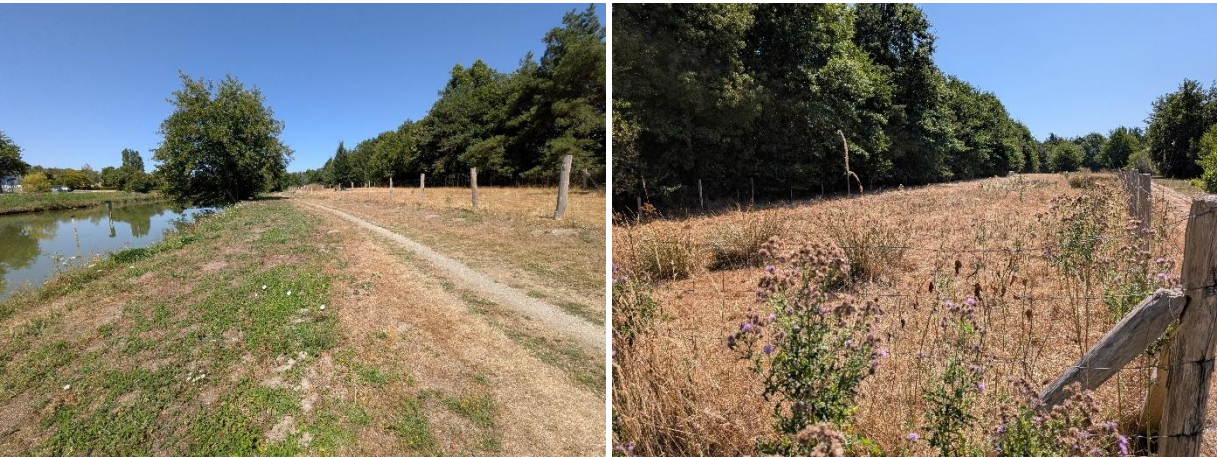
Figure 30 : Dysfonctionnements : Tassement, remblai et surpâturage constatés sur le secteur Nord du plan d'eau aval (CDCB juin 2026)
